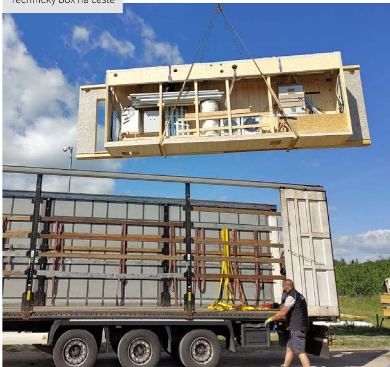
Technický box na cestě
